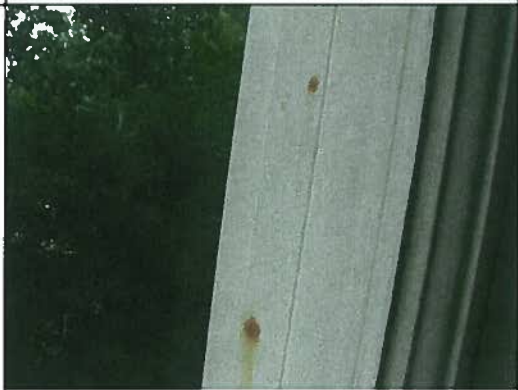
117. Rust on exterior jamb of Unit E2.
